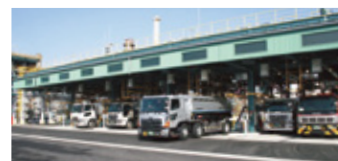
四国事業所 陸上出荷設備
