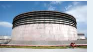
石油製品を貯蔵する大型タンクを所有し、沖縄県全域の需要に十分に対応できる量の石油製品を保管することが可能です。
