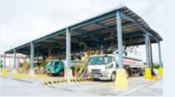
石油製品は、陸上出荷設備にてタンクローリーに積み込まれ、本島各地への安定供給をしております。
